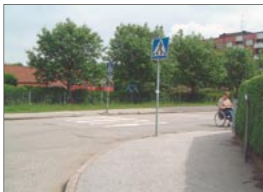
Före: övergångsställe med smala avfasningar med för stor lutning, ingen taktil information och dålig målning.
