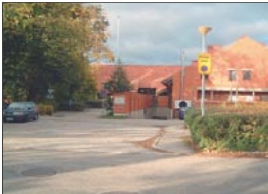
Före: smal gångbana med kraftigt tvärfall och ojämnheter, avfasning saknas.
