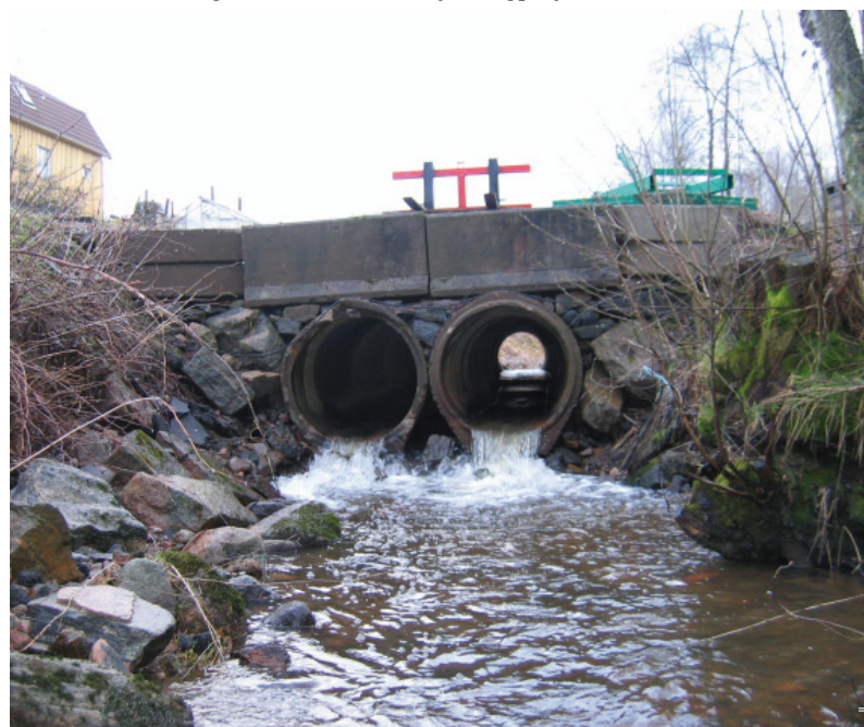
Figur 5.2:2 Vandringshindret i Bäsjöbäcken strax uppströms E20 kan åtgärdas inom ramen för vägprojektet.
