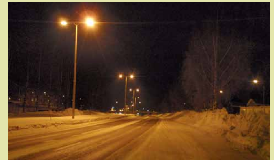
E4 norr om trafikplats Skellefteå norra, här med dubbla körfält och björkallé och gatubelysning som är placerad i mittremsan av vägen.
