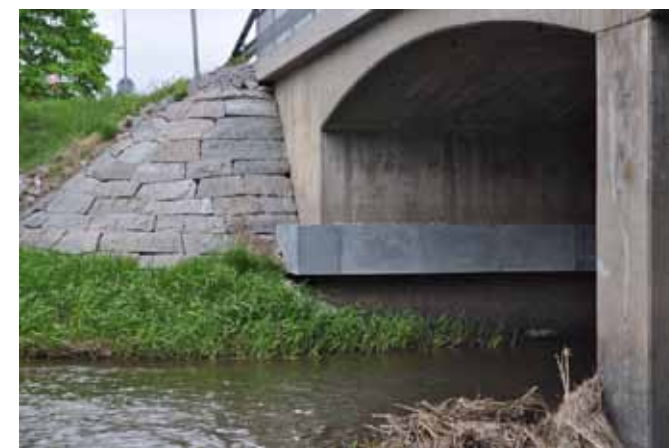
Figur 50. Utterpassage, Olandsån i Hökhuvud.
