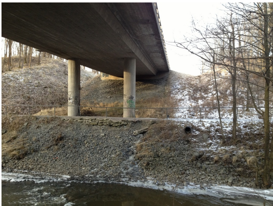
Foto 1. Västra sidan mot brostöd 2, befintligt erosionsskydd som ska förbättras. Foto taget mot väst.
