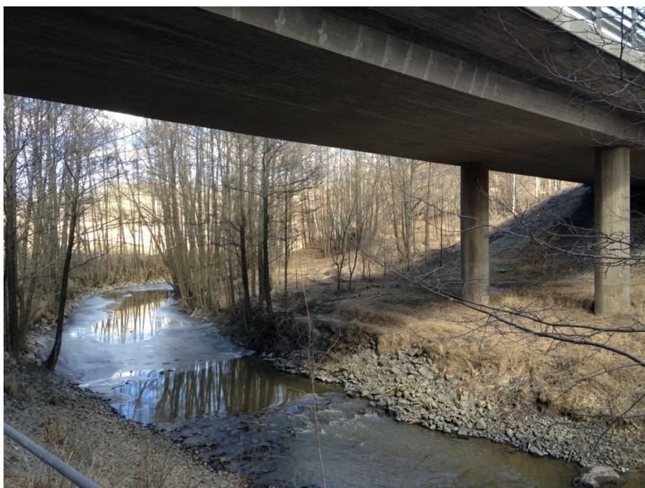
Foto 2. Östra sidan mot brostöd 3, befintligt erosionsskydd som ska förbättras. Foto taget mot nordost.
